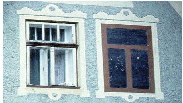
Altfenster brauchen Wartung und Sanierung.
